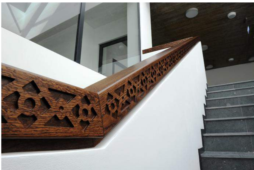
Ryc. nr 61. Zdobione drewniane balustrady w budynku CNIM przy ul. Marcinkowskiego 2-6 (Aut. Renata Sławińska)
