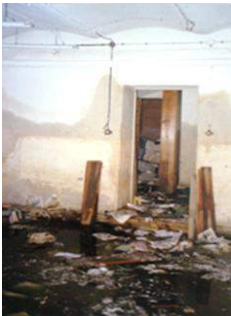
Ryc. nr 3. Ślady pokazujące poziom wody w budynku Biblioteki przy ul. Parkowej 1/3 (Zofia Strożecka-Tichy)
