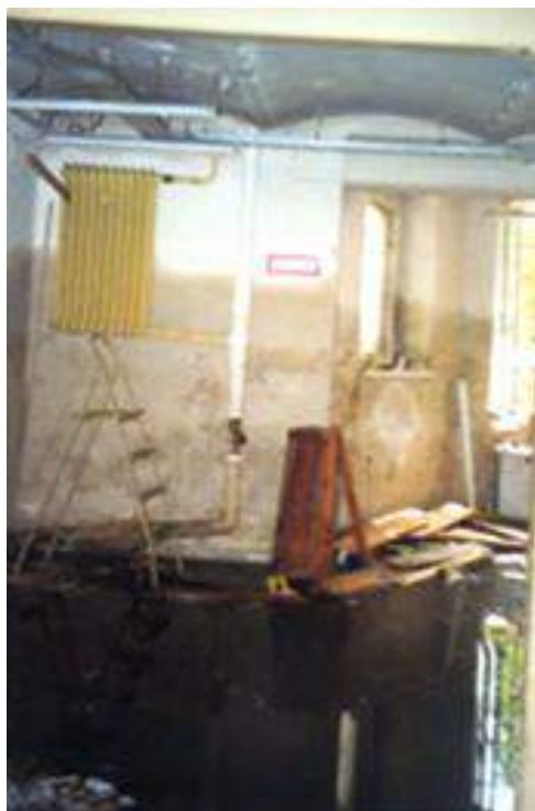
Ryc. nr 53. Ślady pokazujące poziom wody w budynku Biblioteki przy ul. Parkowej 1/3 (Aut. Zofia Strożecka-Tichy).
